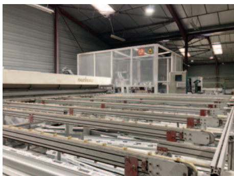
Centre de débit et usinage de l'atelier de production de menuiseries PVC.
